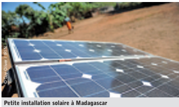
Petite installation solaire à Madagascar
